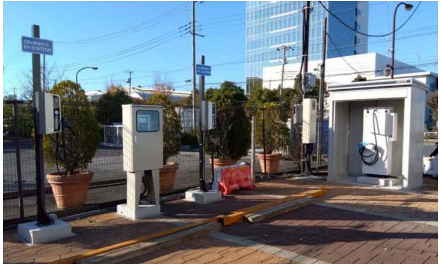
塩害対策用設置事例
