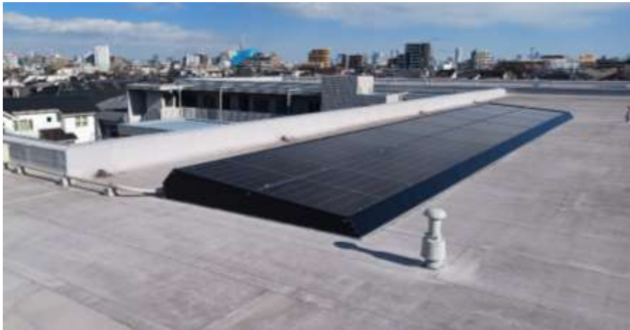
太陽光パネル
