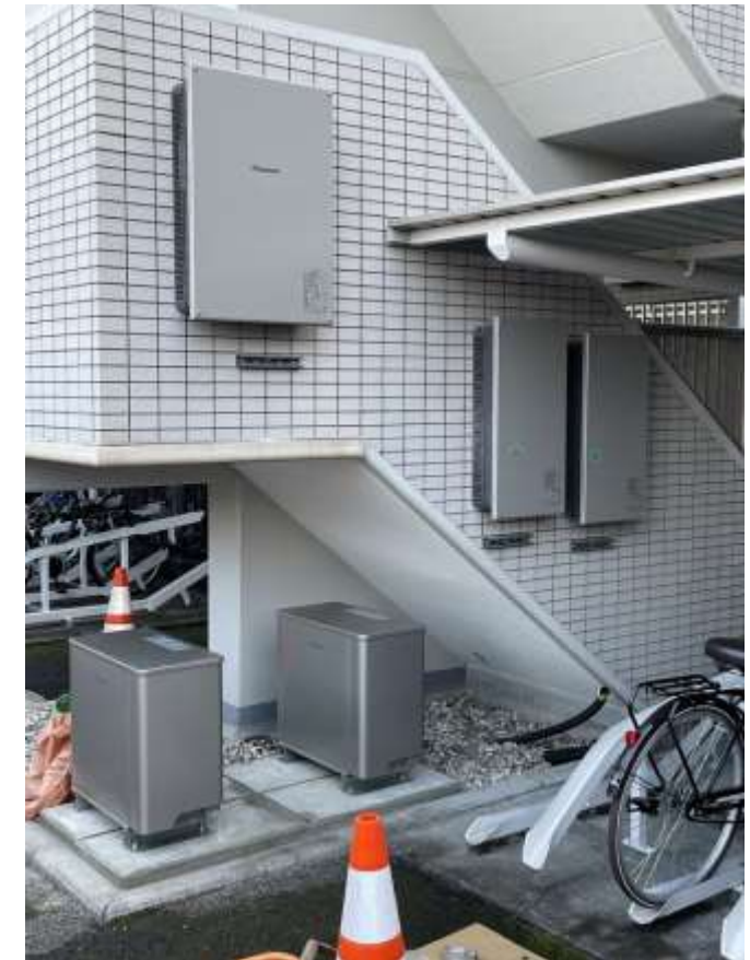
パワコン &amp; 蓄電池
