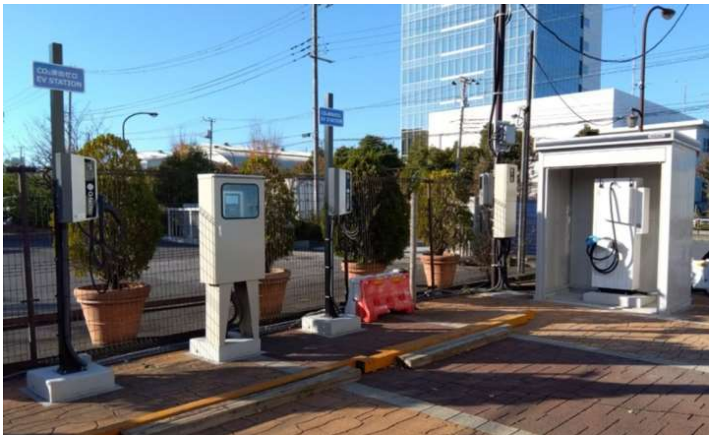
塩害対策用設置事例
