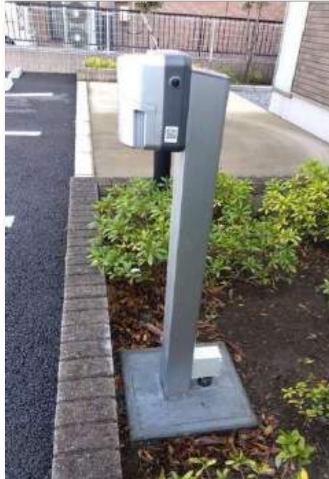
EV充電器 屋外
