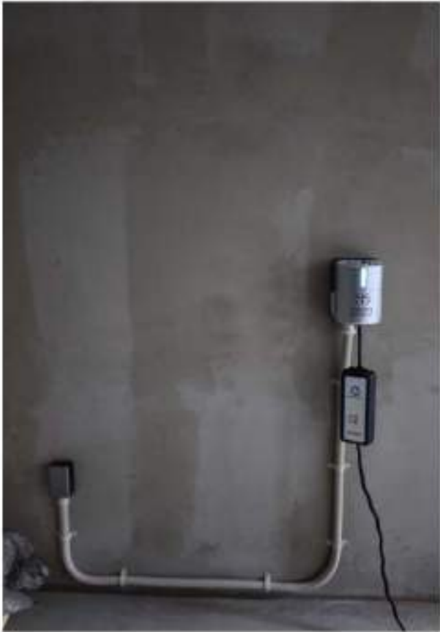
EV充電器 ※壁面設置
